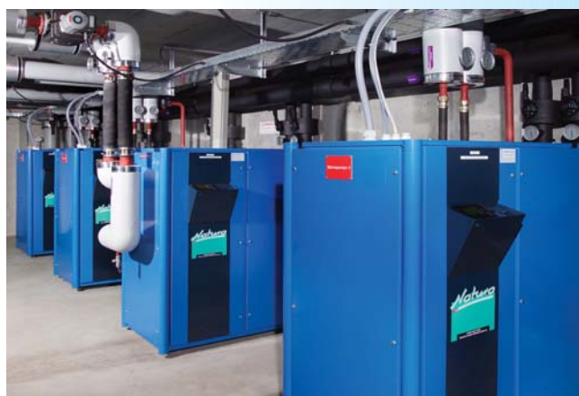
Les pompes à chaleur permettent de produire de l'eau chaude à 70 °C à partir d'eaux usées à 12 °C. Photo: Satag Thermotechnik
